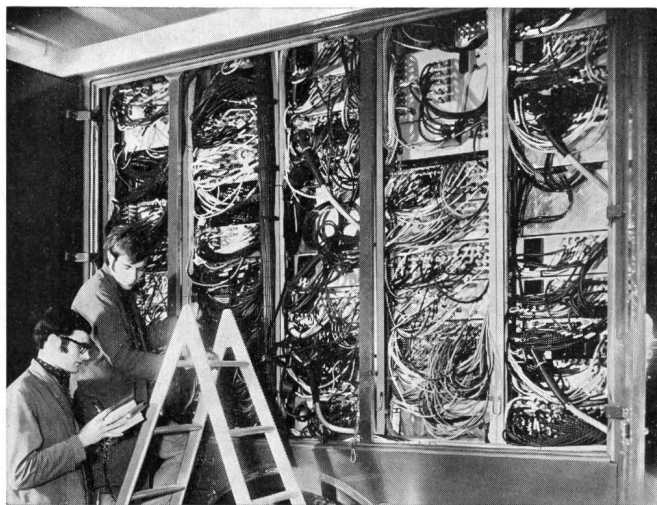
Fig. 10 Bei geöffneter Servicetüre liegt die Rückseite der Gestelle I bis V vollständig frei zur Überprüfung und Reparatur der Verkabelung. Lorsque la porte de service est ouverte, le revers des bâtis I à V est entièrement accessible pour le contrôle et la réparation du câblage.
