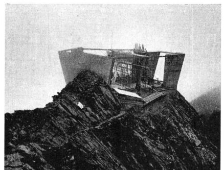
Fig. 6 Umlenkantennenanlage (Passivrelais) Gesero während des Baues
