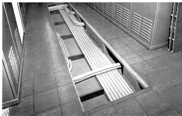
Fig. 10 Führung der Speisekabel im Kanalsystem Disposition des câbles d'alimentation dans les canalisations
