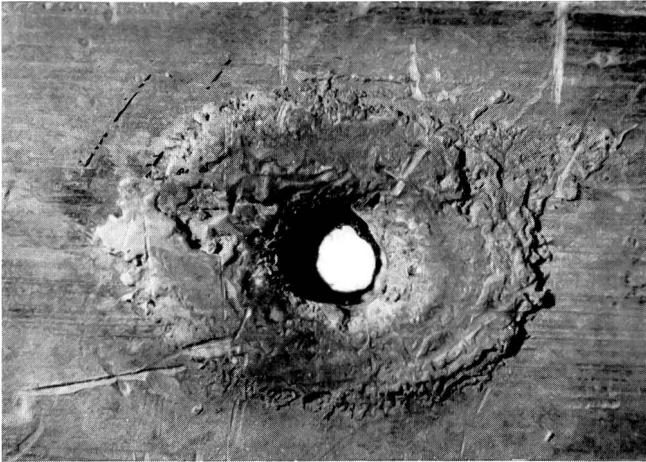
Fig. 2 Loch von 2 mm Durchmesser im Bleimantel eines Kabels mit Thermoplastumhüllung (Fernmeldekabel in Wasserstollen) Trou de 2 mm de diamètre dans la gaine de plomb d'un câble à enveloppe thermoplastique (câble téléphonique dans une galerie d'eau)
