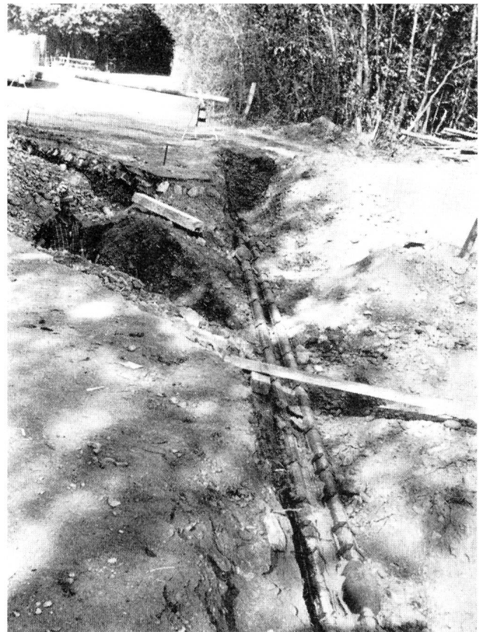
Fig. 4. Die Schadenstelle nach der Behebung der Kabelstörung. Vorne rechts und hinten links die Kabelschutz- muffen
