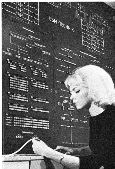
Fig. 3. Prüfroboter melden automatisch allfällig auftretende Störungen und registrieren sie auf einem Lochstreifen. Unser Bild zeigt die Übersichts- und Meldetafel, auf der sich die Informationen aus dem Lochstreifen zur Fehlerlokalisierung übersichtlich darstellen lassen
