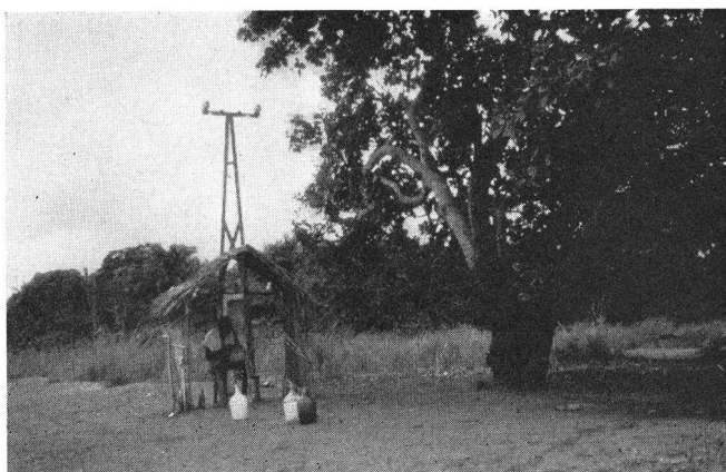
Fig. 5. Ligne aérienne Léopoldville-Matadi; cabine pour point de coupure (utilisée comme débit de vin de palme)
