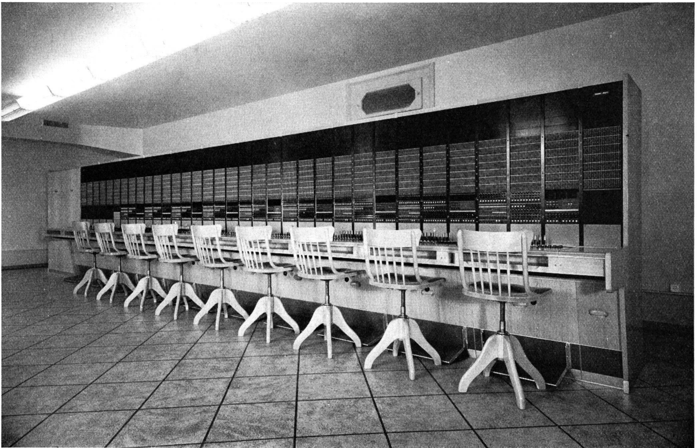
Fig. 11. Ansicht der Vermittlerschränke — Vue du commutateur
