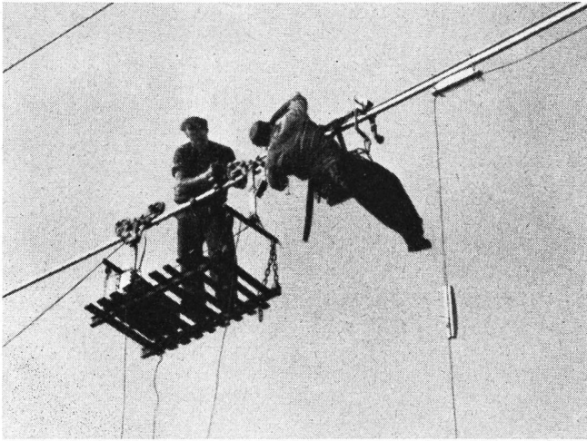
Fig. 15. Befestigung des Kabels vom Montagewagen aus Fixation du câble à partir du chariot de montage
