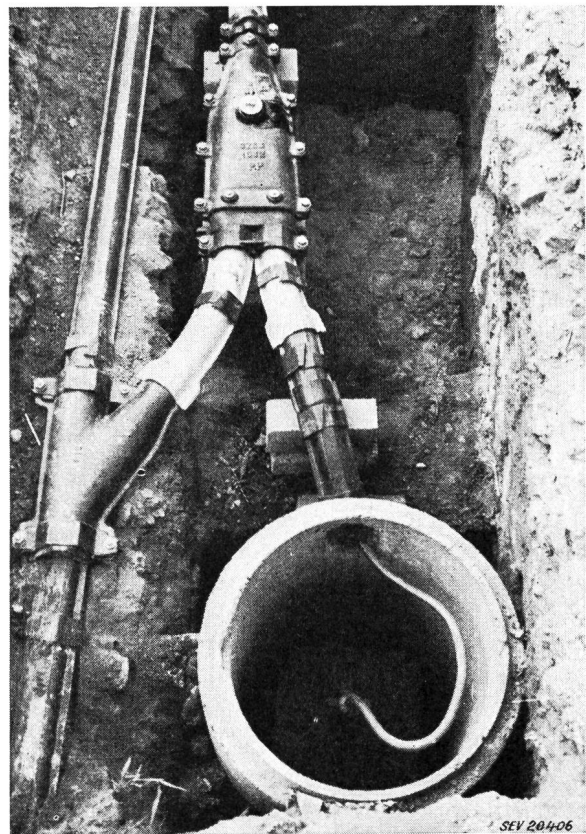
Fig. 1. Fernkabel mit Abzweigmuffe und Pupinschacht
