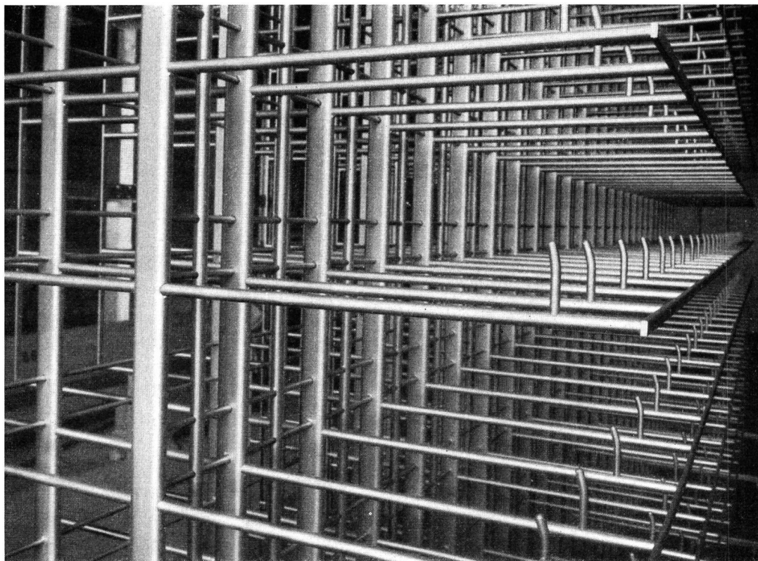
Fig. 7 Fernverteiler Luzern, Horizontalseite Distributeur interurbain de Lucerne, côté hori- zontal
