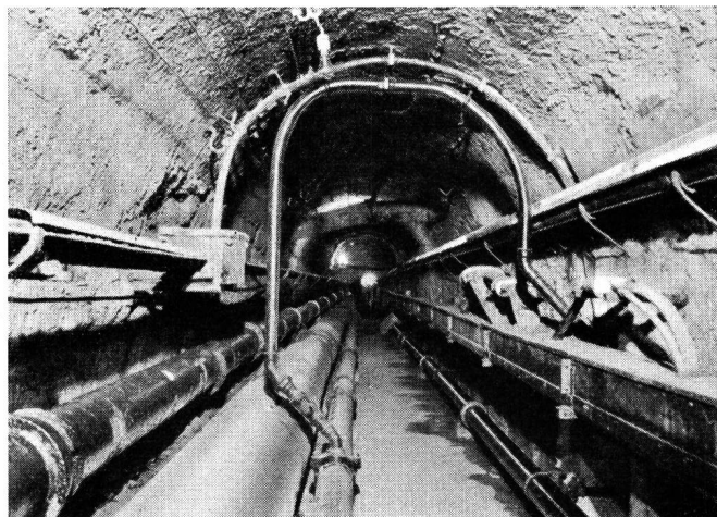
Fig. 7. Conduites industrielles posées dans une galerie
