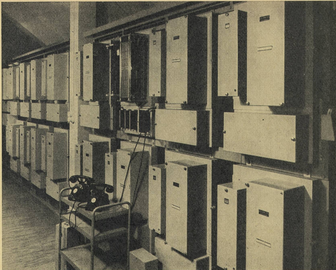
Gestellreihe mit Leitungsdurchschaltern
