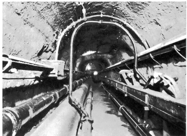
Fig. 10. Werkleitungen in einem Stollen
