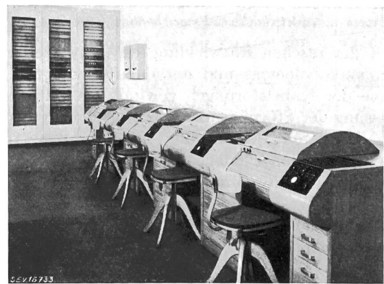
Fig. 13. Beispiel einer Grossnebenstellenanlage für Fernschreiber bei der Stadtpolizei Zürich
