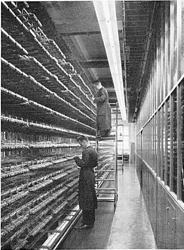
Fig. 14. Horizontal- oder Stripsseite des in Abbildung 13 wiedergegebenen Hauptverteilers
