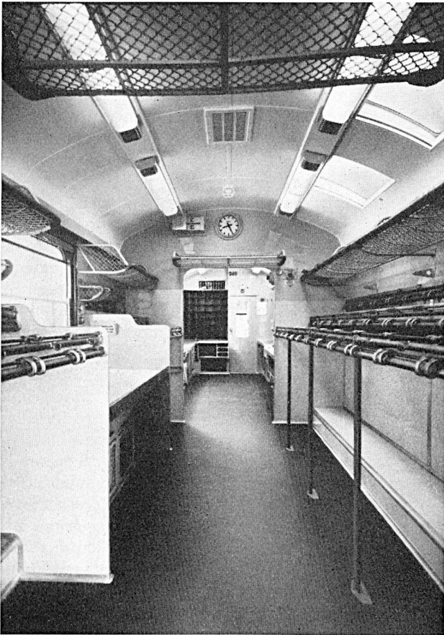
Fig. 17. Beleuchtung eines Bahnpostwagens. Durchblick vom Sackraum ins Bureau. U-förmige Kaltkathoden-Fluoreszenzlampen in Diffusoren aus Plexiglas. Installierte Leistung 700 W ab Batterie. Lichtquelle 4500° K. Stromquelle: Vibratoren zur Umformung des Gleichstroms in Wechselstrom 50 Hz. Baujahr 1947/48
