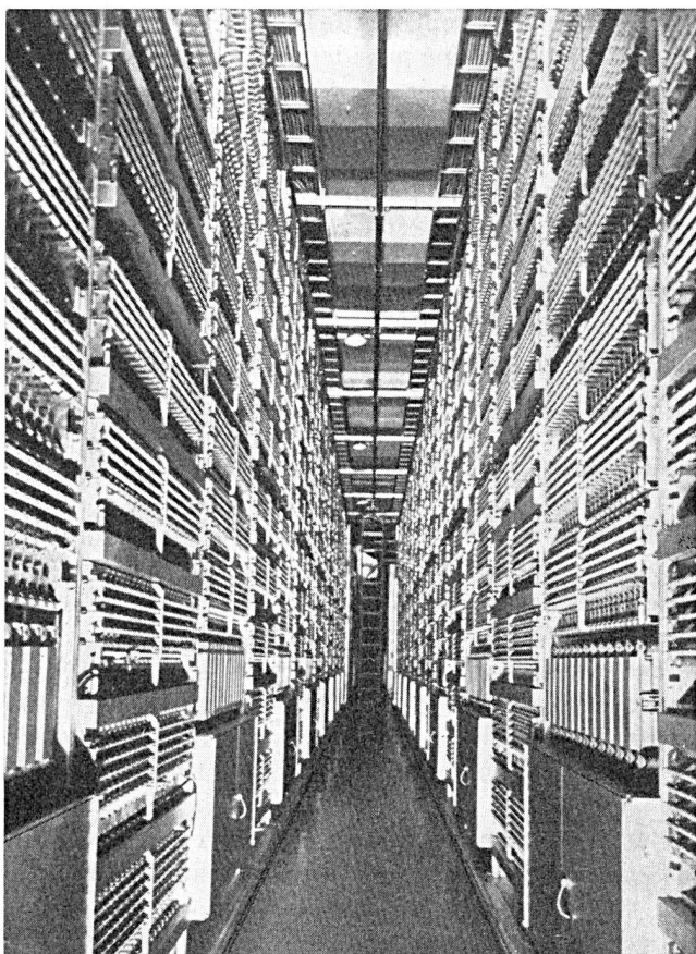
Fig. 2. Vue générale d'un central téléphonique local du système «Crossbar»
