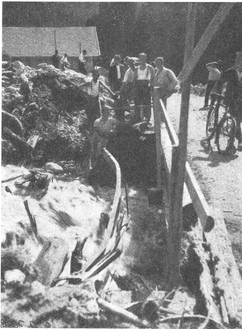
Bild 3. Zerstörte Kabelüberführung über den Monsteinerbach.
