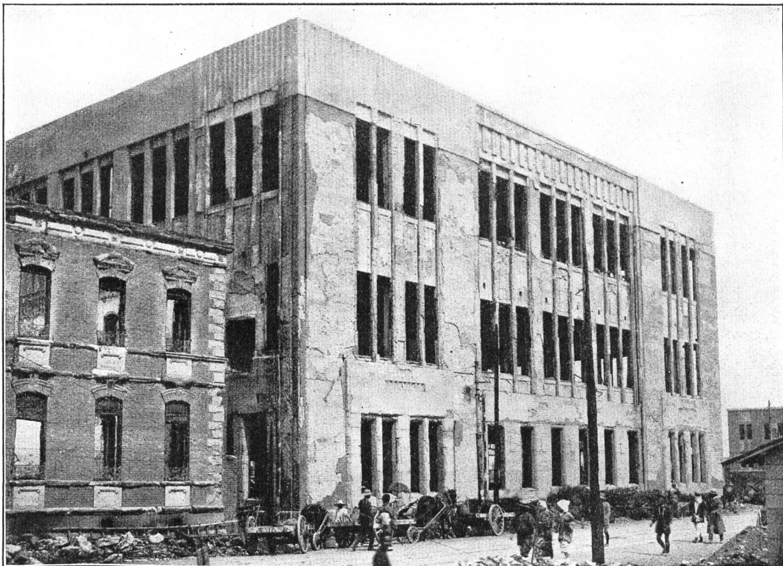
Gebäude der beiden Fernsprechämter Hamacho und Horidome in Tokio nach dem Brande. In diesem Bau aus Eisenbeton soll neuerdings ein Zentralbatterieamt untergebracht werden. Der Ziegelsteinbau ist das Amt Naniwa.
