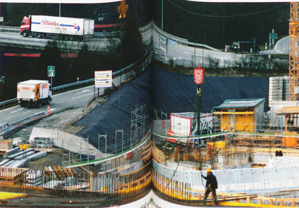
Bern-Brünnen: Construcción de un centro comercial con 11 cines, 10 restaurantes, un hotel y piscina cubierta
