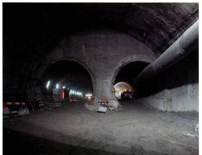
Con sus 57 km, el nuevo túnel de base es el túnel ferroviario más largo del mundo.
