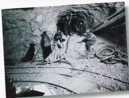
Mineure beim Tunnelbau kurz vor dem Durchstich auf dem Jungfrauojoch am 21. Februar 1912
