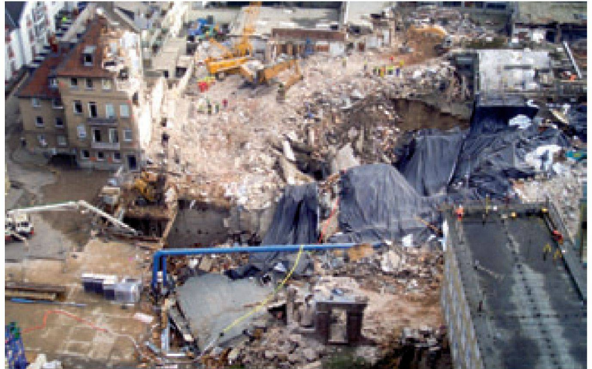
Das zerstörte Gebäude des Historischen Archivs der Stadt Köln an der Severinstrasse 222–228 (Photo: Stadt Köln, Berufsfeuerwehr).
