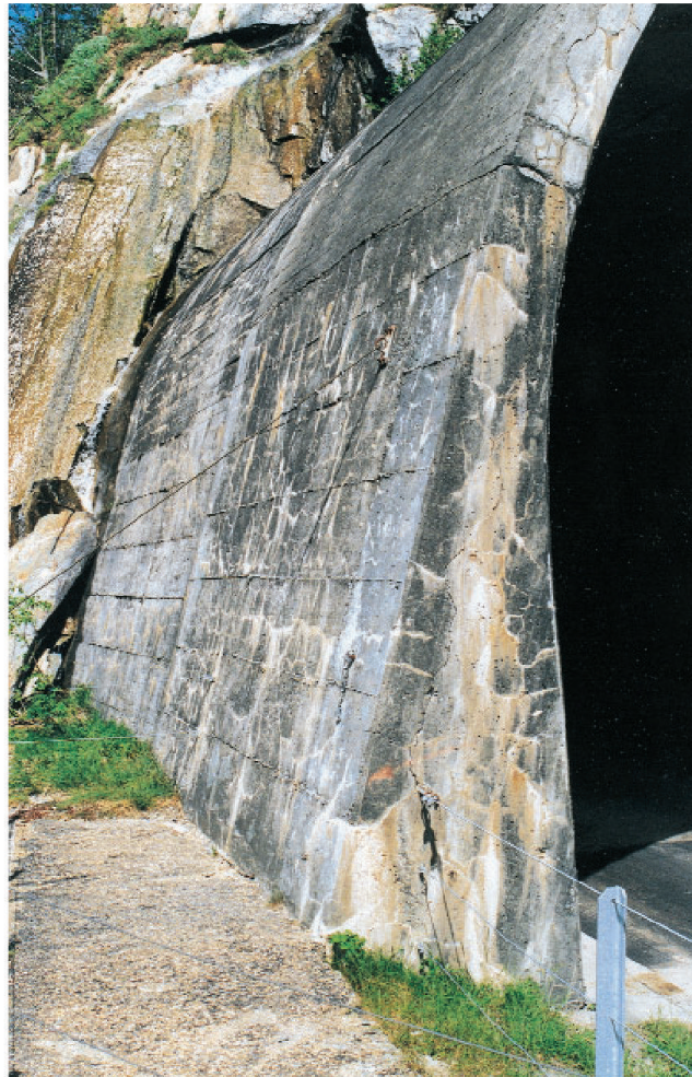
Abb. 5 Überlagerung von statischen, korrosions- und AAR-bedingten Rissen mit Kalkablagerungen. Foto: Fritz Hunkeler, TFB
