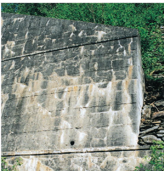
Abb. 2 Überlagerung von statischen, korrosions- und AAR-bedingten Rissen mit Kalkablagerungen.
