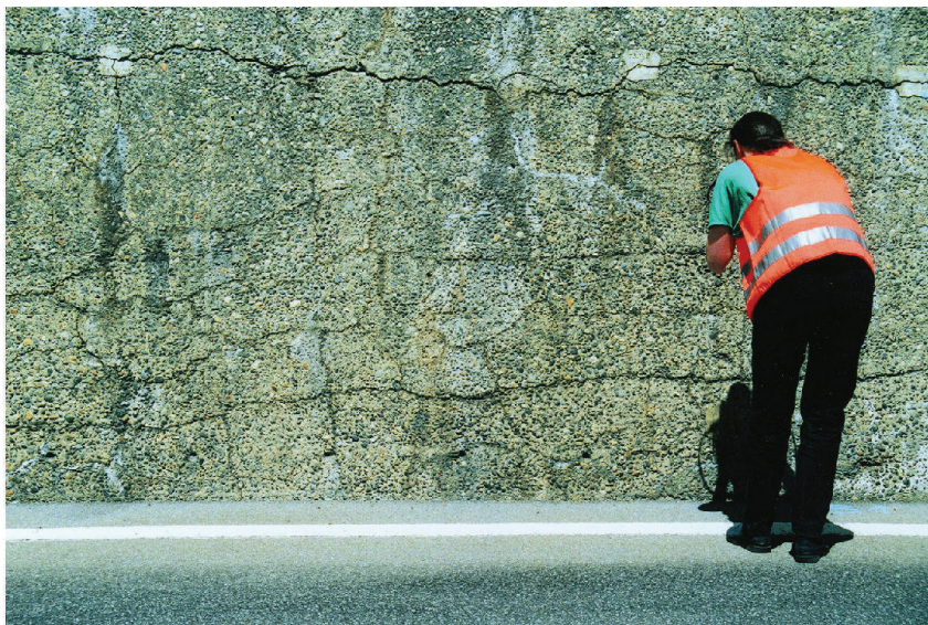
Abb. 3 AAR-Schäden in unbewehrter Stützmauer.
