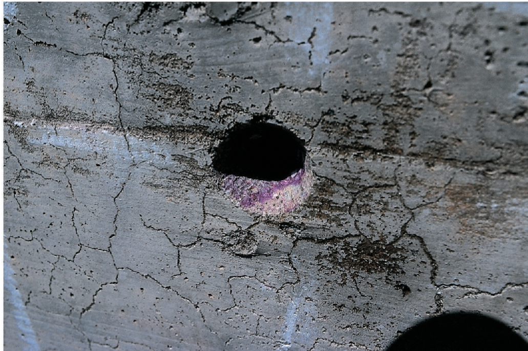
Rissursache: ungenügende Nachbehandlung.
