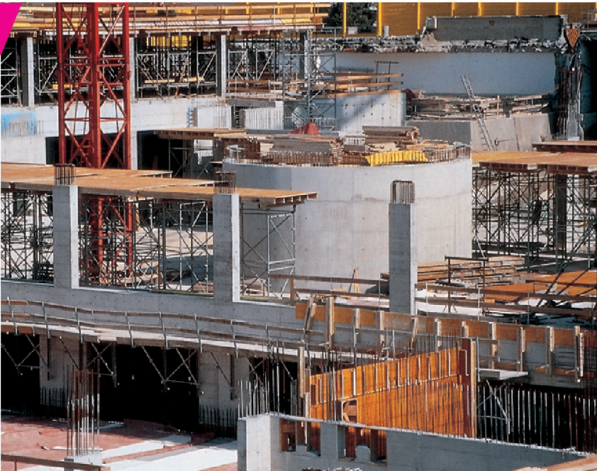
Anwendung von CEM II/A-L 32,5 R in grosser Menge: Laborneubau der ETH Höggerberg, Zürich.
