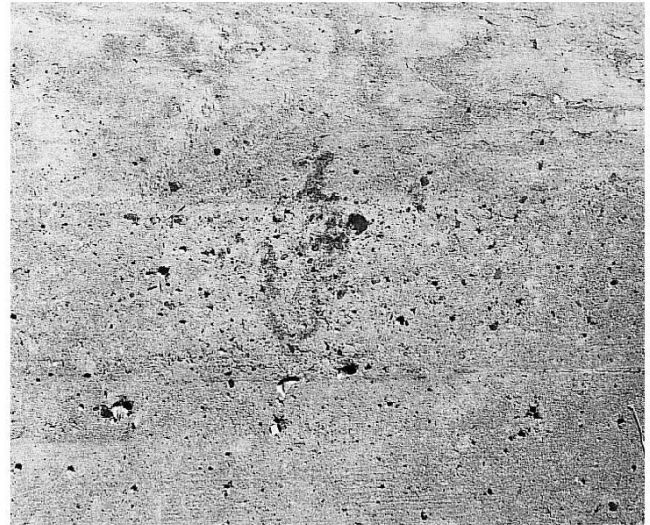
Abb. 12 Die Verunreinigung ist entfernt; es sind nur noch geringe Spuren sichtbar.
