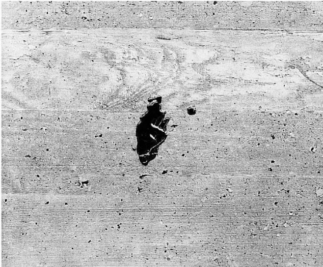
Abb. 1 Durch Bitumen verunreinigte Betonoberfläche.
