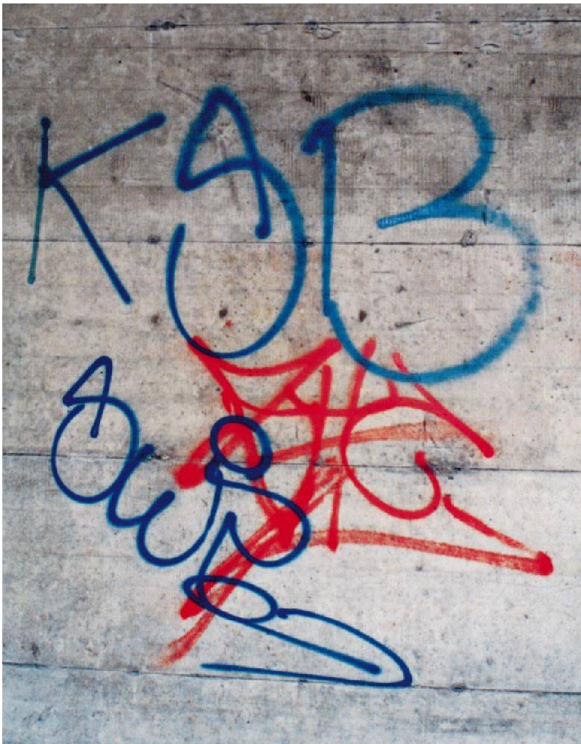
Eine besondere Art von «Betonverschmutzung»: Graffiti.
