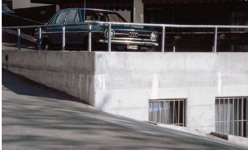
Sichtbetonwände mit Kalk- ausblühungen.
