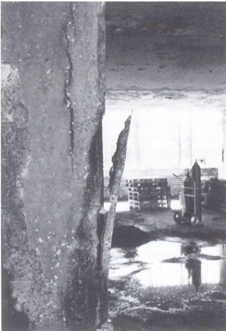
Abb. 4. Abplatzungen an einer brandgeschädigten Stütze.
