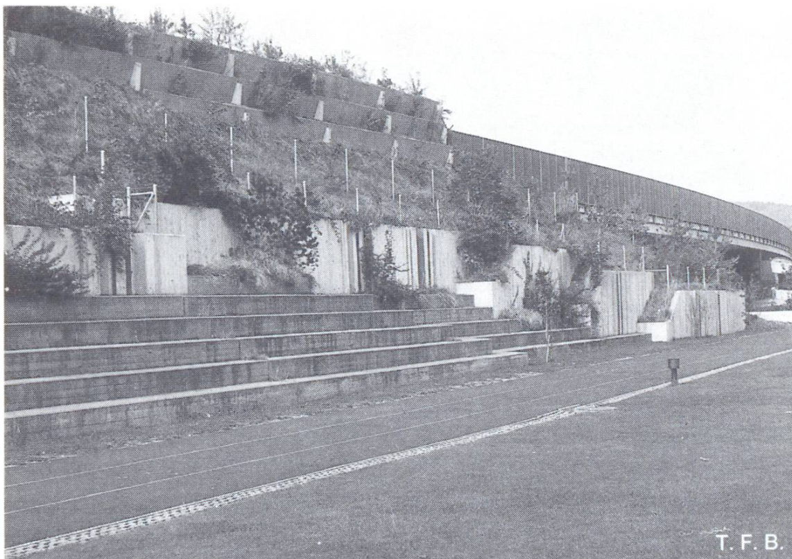
Abb. 4 Stützmauern sind Bauten, bei denen sich Aussehen und Konstruktion gegenseitig durchdringen (Schulhaus Luberzen, Dietikon).
