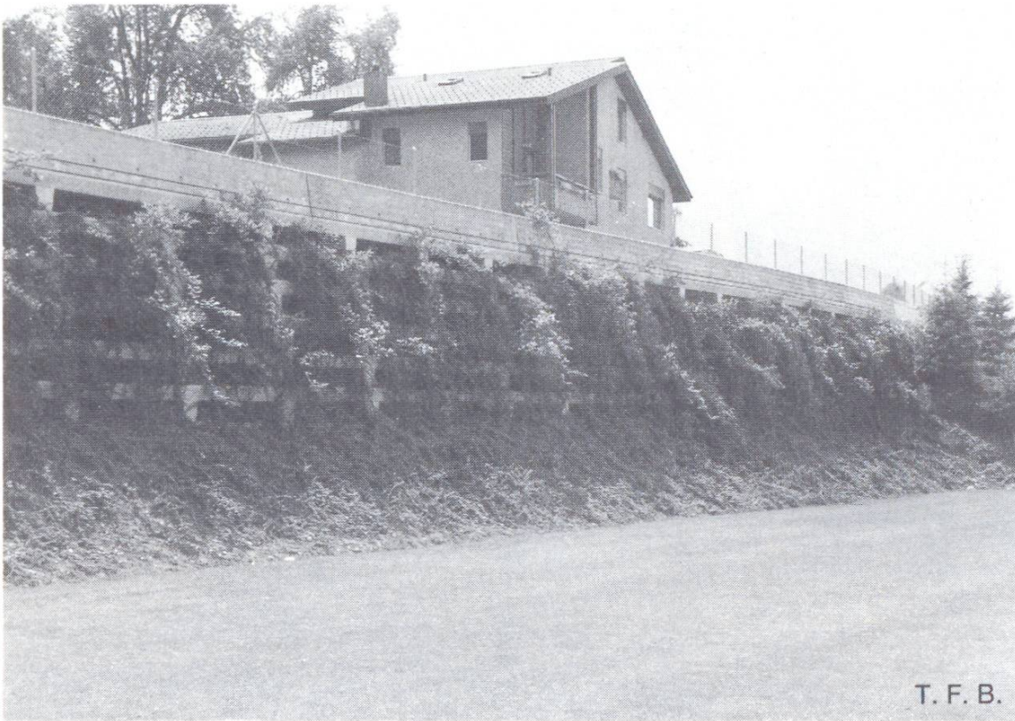
Abb. 3 Zuständigkeit und Kosten für den Unterhalt sind bereits in der Planungsphase zu berücksichtigen (Sportanlagen Buochs. Begrünte Elementstützmauer).
