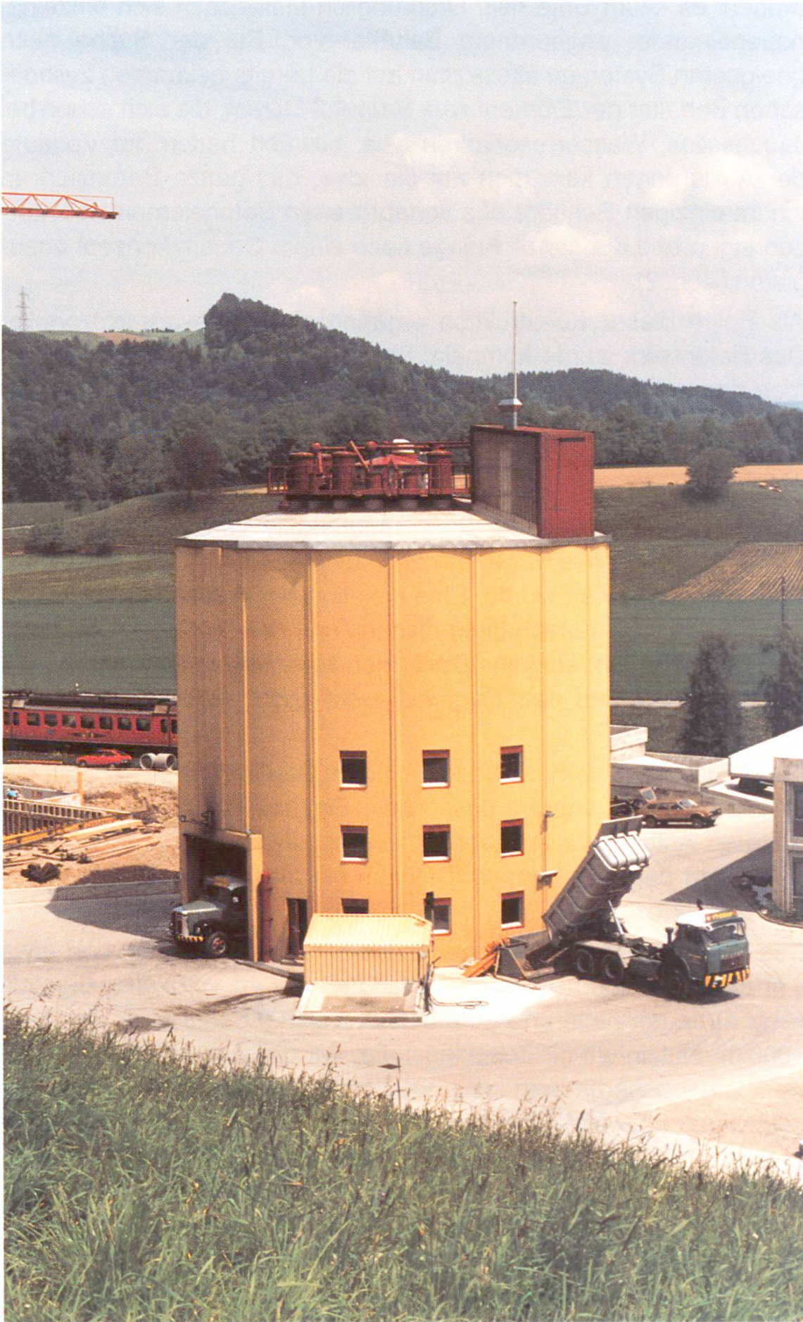
Abb. 10 Das fertige Werk in Betrieb. Einstweilen werden die Zuschlagstoffe noch mit Lastwagen zugeführt.
