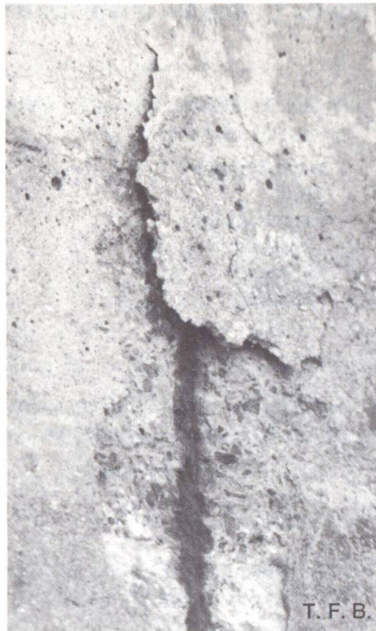
Abb. 5 Aufwölbung und Abplatzung infolge Korrosion der Armierung.
