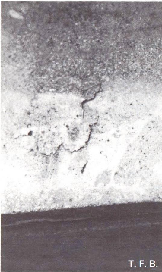
Abb. 4 Aufwölbung. Die Schadenursache ist hier von bloßem Auge noch nicht erkennbar.
