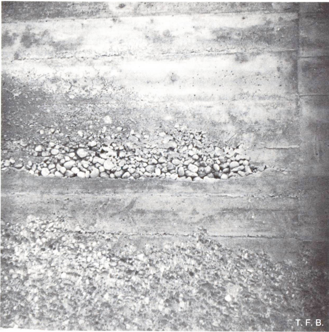
Abb. 4 Korngrößenentmischung im Beton.
