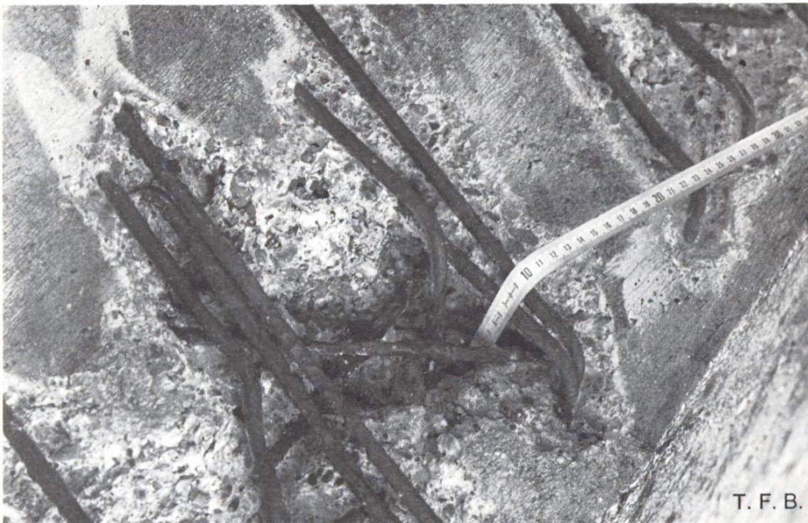
Abb. 5 Armierungskorrosion mit einem ursprünglich wasserreichen und sich entmischenden Beton.
