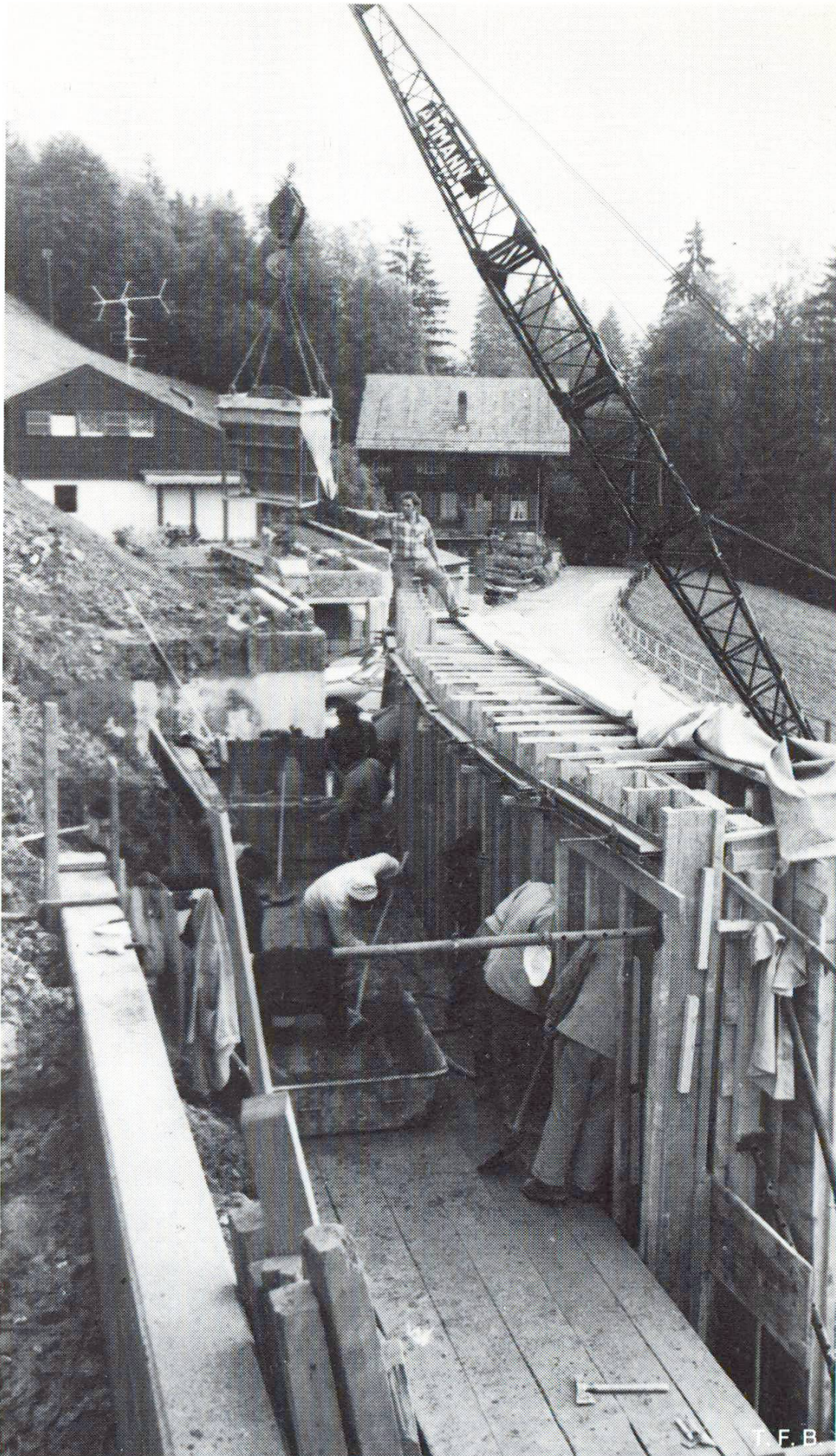
Abb. 4 Die Betonierarbeiten erfolgten von einer rückwärtigen Arbeitsbühne aus. Die oben noch offene Schalung erlaubte eine sorgfältiges Arbeiten und eine gute Kontrolle. Die Abbindeverzögerung des Betons war auf 6 Std. eingestellt.
