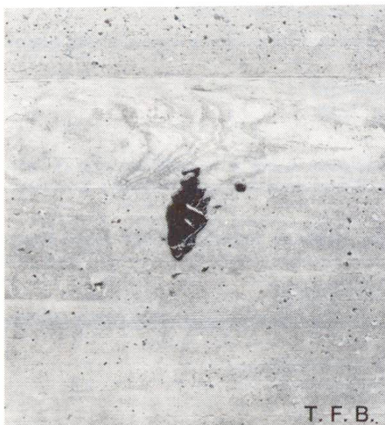
Abb. 1 Sichtbetonfläche verunreinigt durch heisses Bitumen.
