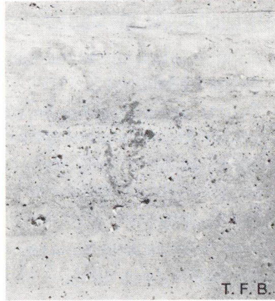
Abb.12 Die Verunreinigung ist entfernt, es sind nur noch geringe Spuren sichtbar.
