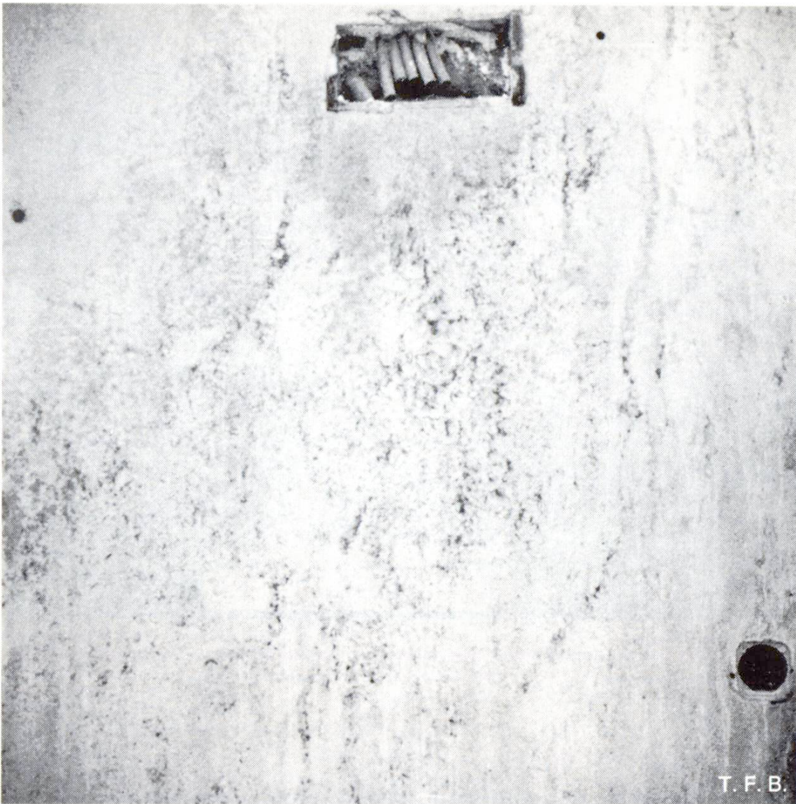
Abb. 5 Wasserausscheidung im Bereich der Schalungsfläche infolge eines zu hohen Wassergehaltes. Die Betonmischung wurde auch zu wenig durchgearbeitet.
