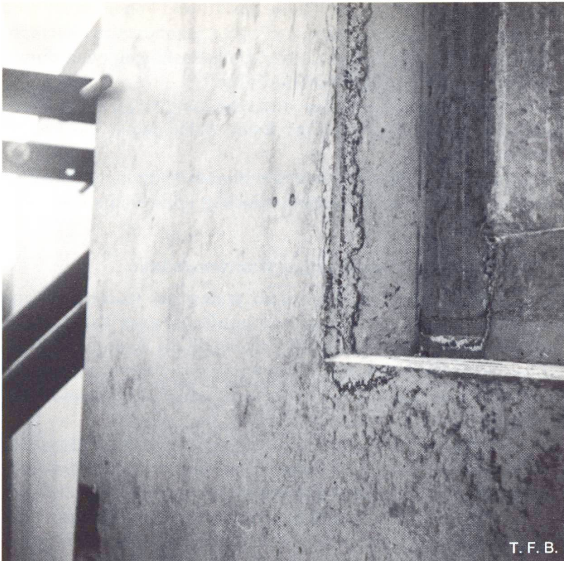
Abb. 2 Folgen der undichten Schalung bei der Kante. Durch ausfließenden Zementmörtel ist der Beton in diesem Bereich geschwächt.
