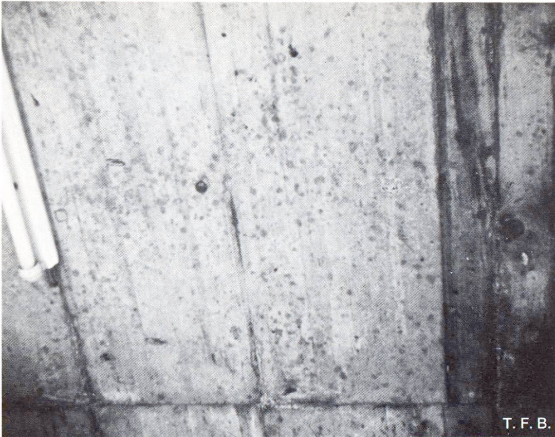
Abb. 4 Zu dünnflüssiger Beton war die Ursache für das Absinken der größeren Zuschlagsgesteine und für eine teilweise Entmischung zwischen Wasser und Zement im Bereich der Schalungsfläche. Die groben Körner des Zuschlages zeichnen sich als dunkle Punkte ab («durchscheinender Zuschlag»). Die unregelmässige Verteilung der Flecken ist auf entsprechende Vibratorwirkung zurückzuführen.
