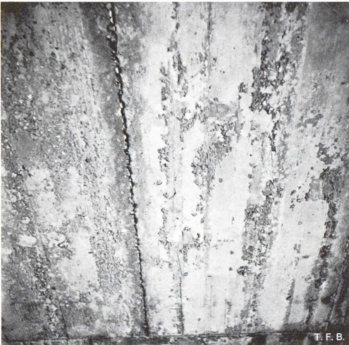
Abb. 5 Beton mit geringem Zementgehalt neigt zur Wasserausscheidung und damit zu Oberflächenschädigungen.
