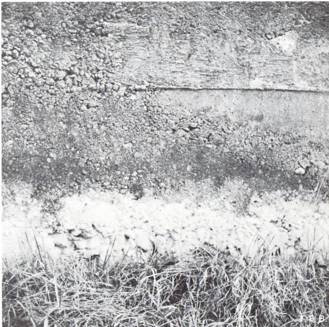
Abb. 6 Mit ungenügend dosiertem Beton kommen Kiesnester und Ausblühungen häufiger vor.
