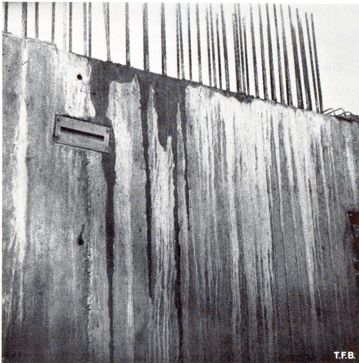
Abb. 8 Fehlende Abdeckung einer Mauerkrone
