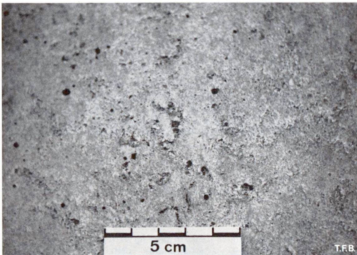
Abb. 2 Starke Luftblasen und örtliche Entmischungen bei einer harschen, sandarmen Mischung.
