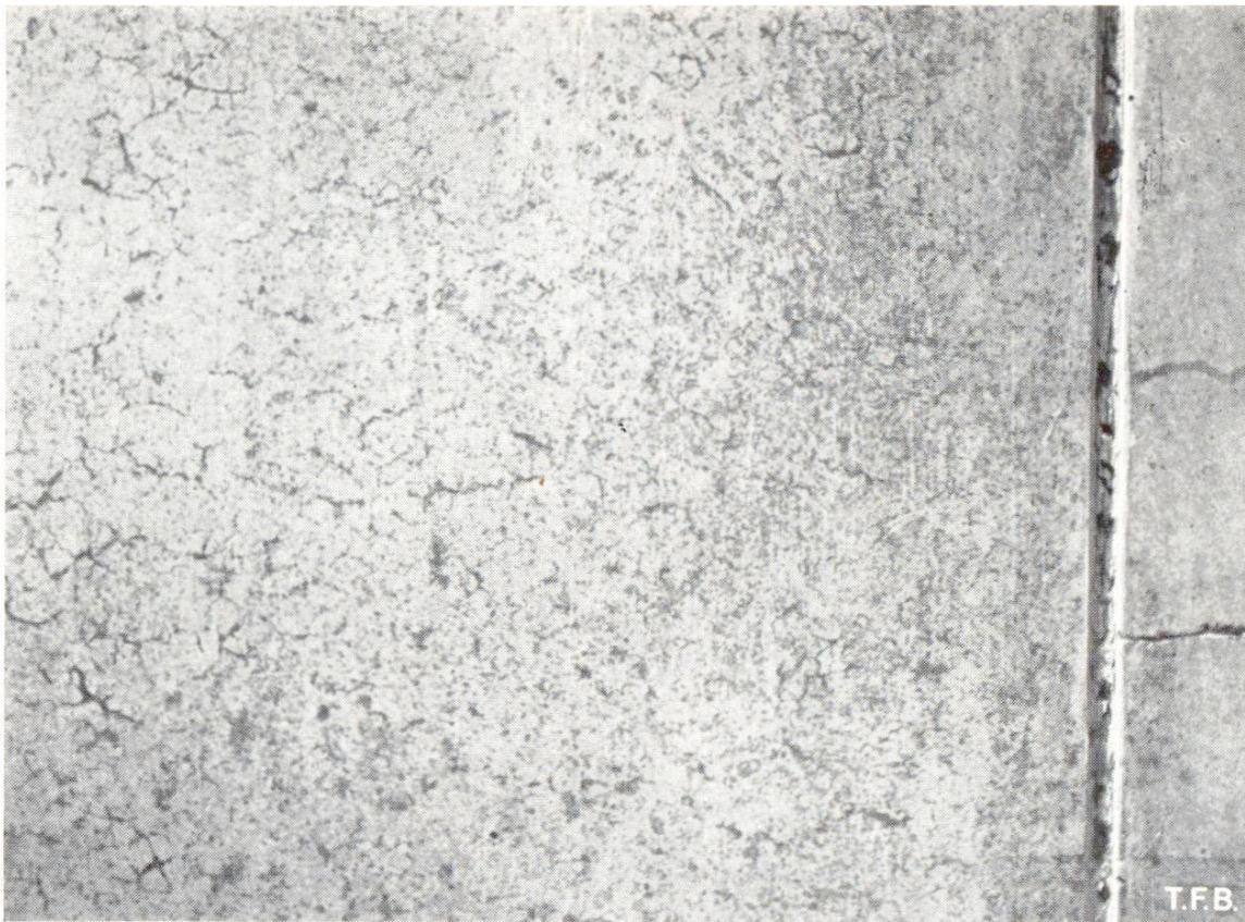
Abb. 2 Feines Netz von «Schrumpfrissen», die frühzeitig unter einer glatten, undurchlässigen Schalung entstanden sind. Am Rand haben sich weniger Risse gebildet.
