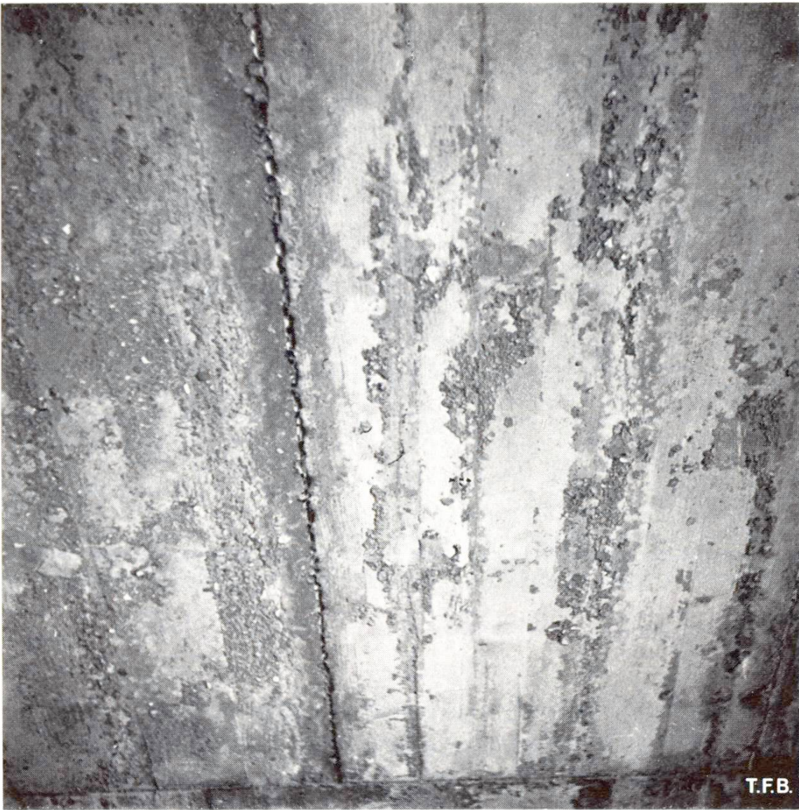
Abb. 5 Abscheren der Oberfläche von «jungem Beton» in einer Deckenschalung infolge von Durchbiegung oder Erschütterung.
