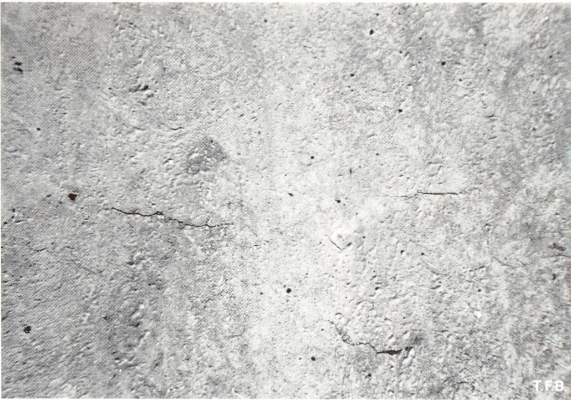
Abb. 3 «Setzungsrisse» infolge eines geringen Abgleitens von «jungem Beton» in der Schalung.
