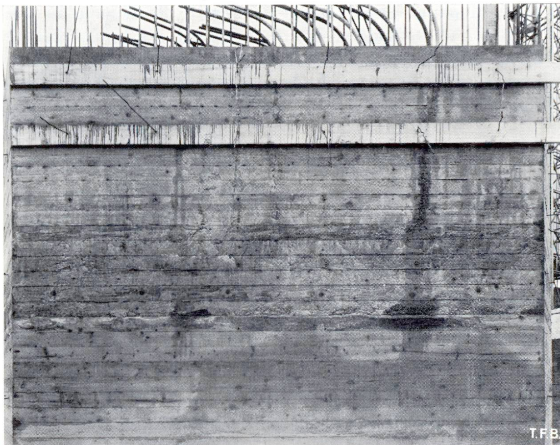
Abb. 2 Sichtbetonwand im allgemeinen mit zu flüssigem Beton erstellt. In der unteren Hälfte einer Betonierfuge vom Typ 3 mit schlecht verdichtetem Anschluss der oberen Lage. In der Bildmitte eine Betonierfuge vom Typ 1 mit deutlichen Spuren starker Wasserausscheidung (senkrecht aufsteigende Rinnschienen und entsprechende wolkenförmige Unterschiede in der Grautönung). Fast schwarz zeichnende Stellen infolge von Regennässe in stark porösem Beton.
