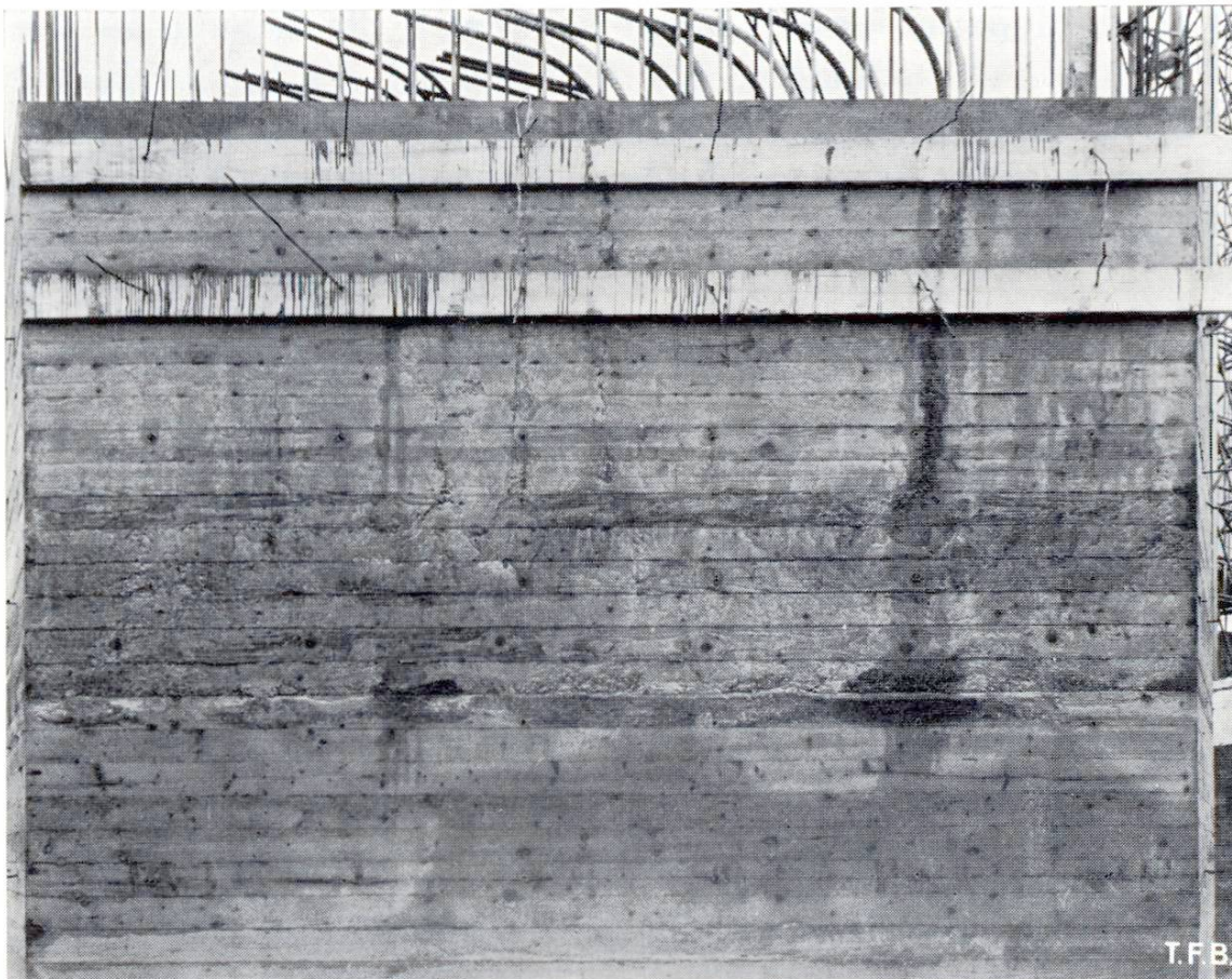
Abb. 2 Sichtbetonwand im allgemeinen mit zu flüssigem Beton erstellt. In der unteren Hälfte einer Betonierfuge vom Typ 3 mit schlecht verdichtetem Anschluss der oberen Lage. In der Bildmitte eine Betonierfuge vom Typ 1 mit deutlichen Spuren starker Wasserausscheidung (senkrecht aufsteigende Rinnschienen und entsprechende wolkenförmige Unterschiede in der Grautönung). Fast schwarz zeichnende Stellen infolge von Regennässe in stark porösem Beton.
