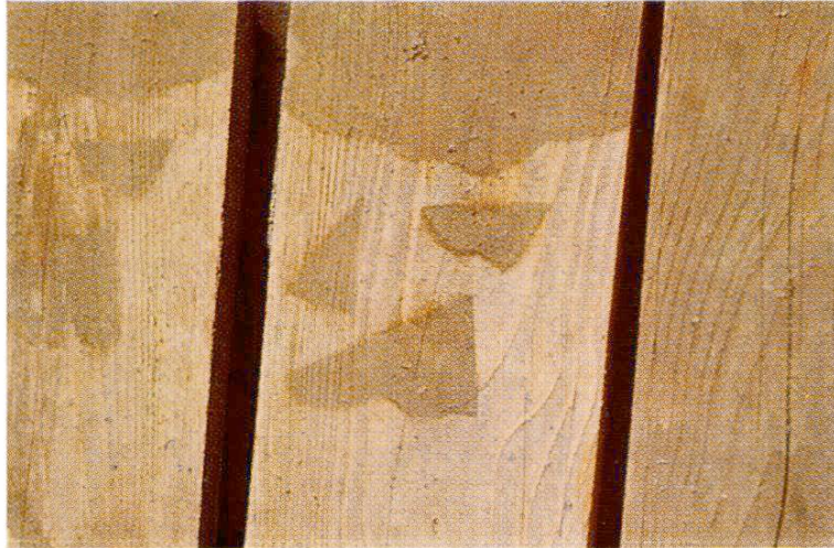
Abb. 4 Ansicht der Bretter nach dem Ausschalen. Im Bereich der Schädigungen bleibt eine Schicht nicht erhärteter, absandender Zement haften.
