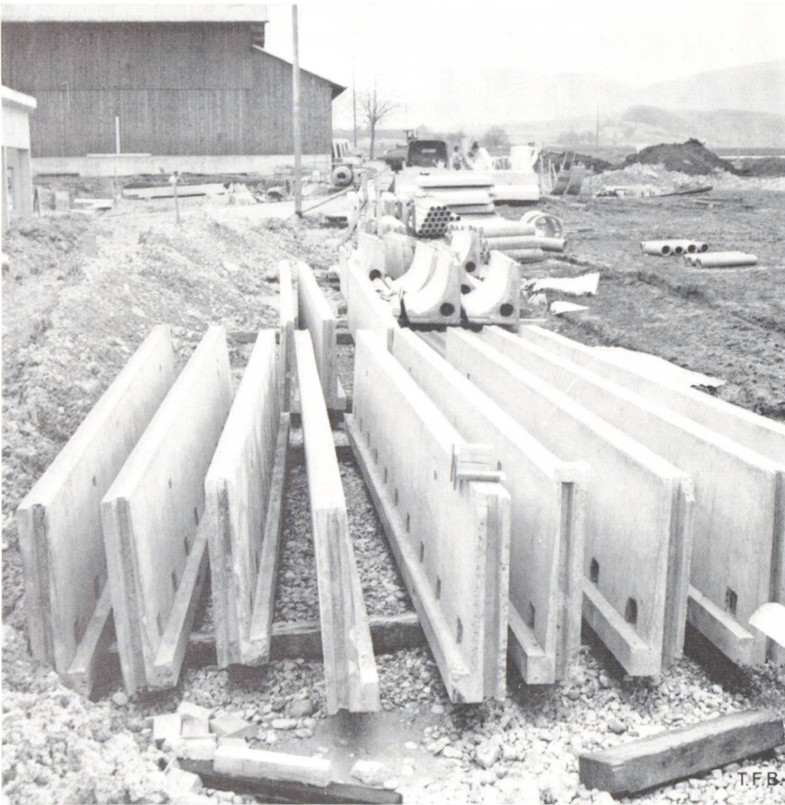
Abb. 1 Verschiedene Bauelemente warten auf den Einsatz. Im Vordergrund Platten für die Mistrinne mit Schubstangenentmischung, dahinter vorfabrizierte Krippen.
