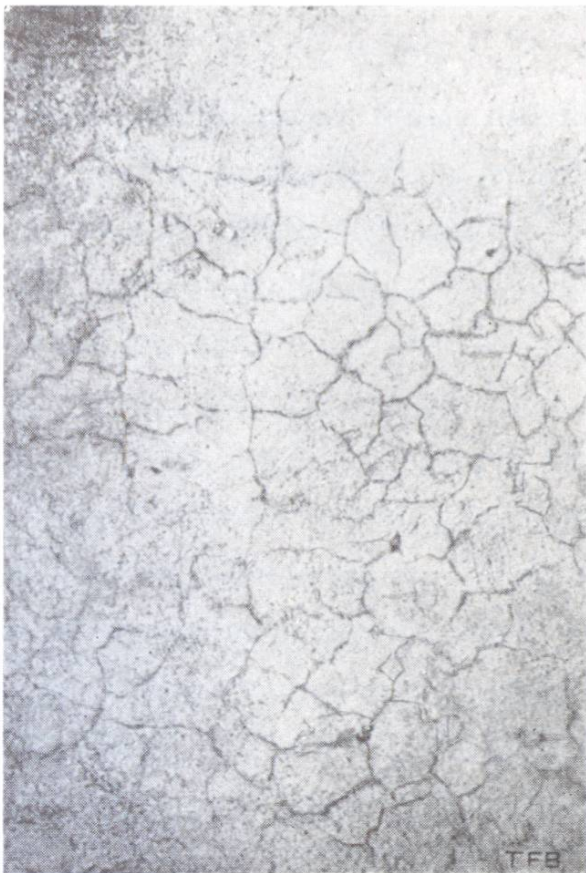
Abb. 2 Schwindrisse in Verputz, der mit einem Übermass an feinem Sand hergestellt wurde und ausserdem vorzeitig ausgetrocknet ist
