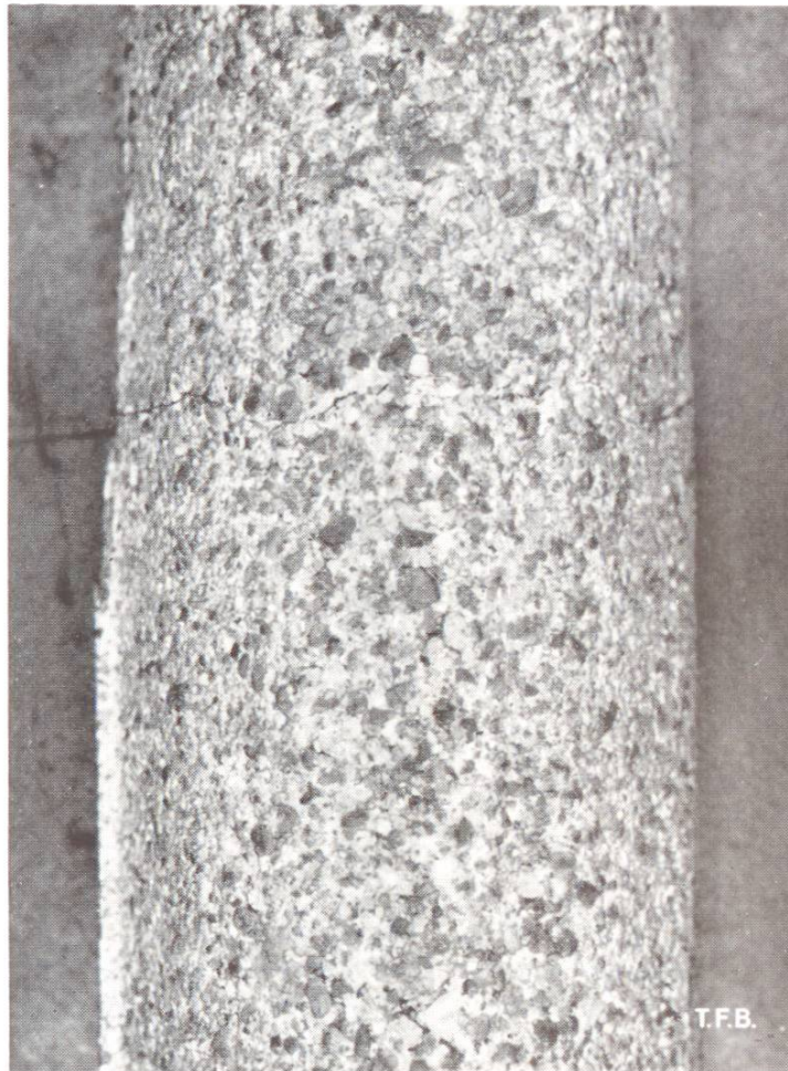
4 Abb. 3 Vergrößerte Wiedergabe von Betonoberfläche, die während ca. 40 Jahren destilliertem Wasser ausgesetzt war
