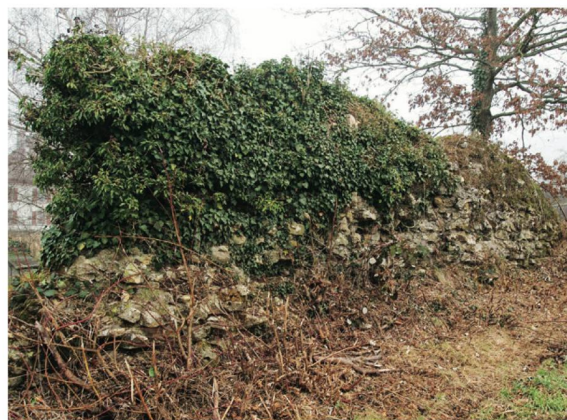
665 Teilstück T6–T7_M1. Erhaltenes Kernmauerwerk, welches im oberen Teil vollständig mit Efeu überwachsen ist.
