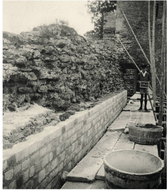
668 Auf dem Baugerüst nördlich von T2. Links im Bild ist der originale Mauerkerne der Kurtine (T2–T3_M1) zu sehen, davor ist die Mauerschale aus Handquadern wieder aufgemauert worden. Im Hintergrund ist die Nordfassade von T2 mit anhaftenden Teilen der Kurtine erkennbar (12.8.1927).
